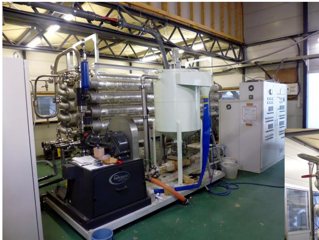
水熱可溶化システム全景
