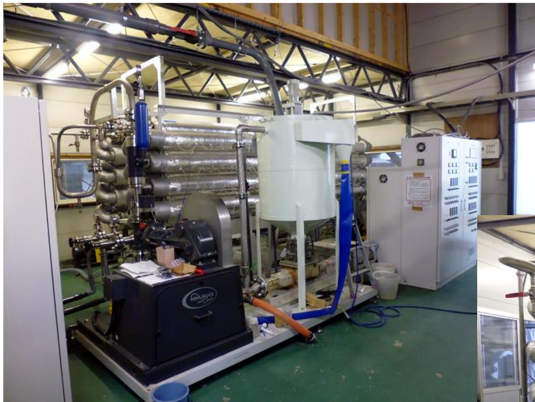
水熱可溶化システム全景
