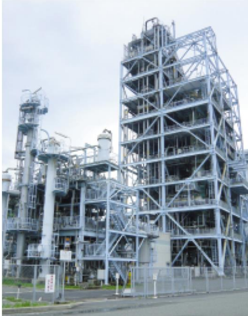
Eagleパイロットプラント (J-Power、若松)
